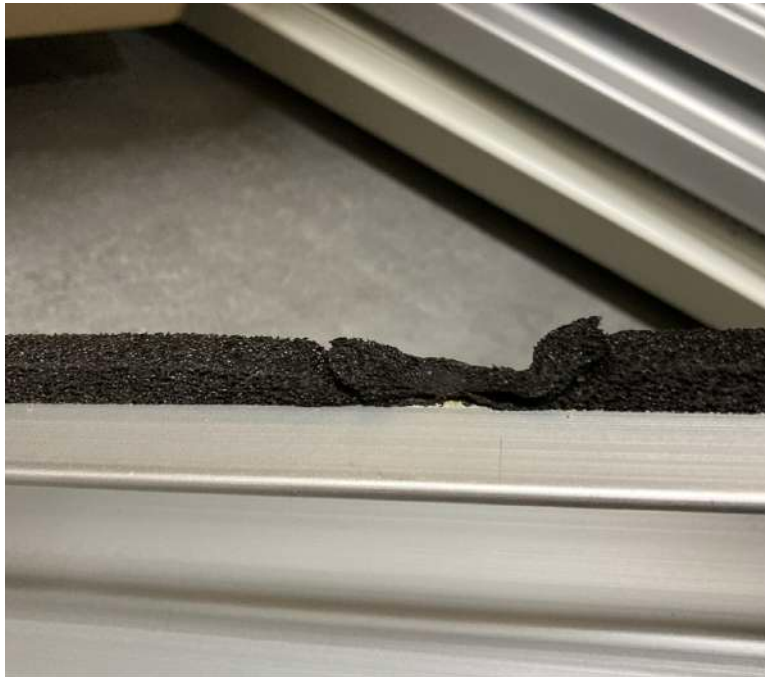
①部分的に止水ゴムが痛んでいる例
